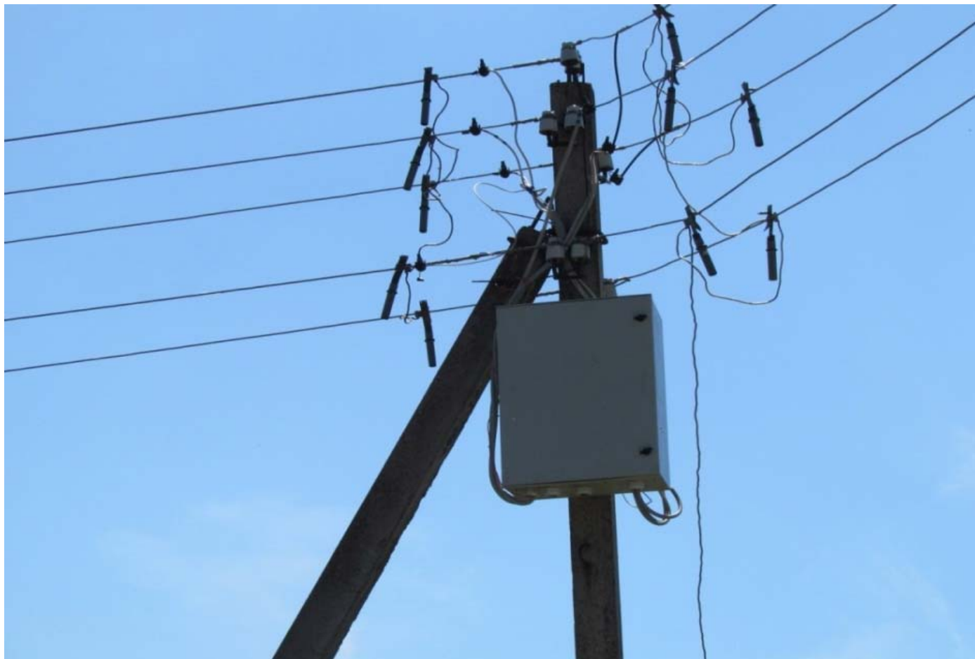
Вид смонтированного ВРУСТ
